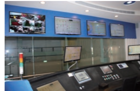
控制暨資料處理 System Control and Data Acquisition(SCADA) Software
