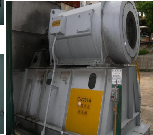
▲ 加熱爐送風機 580kW
